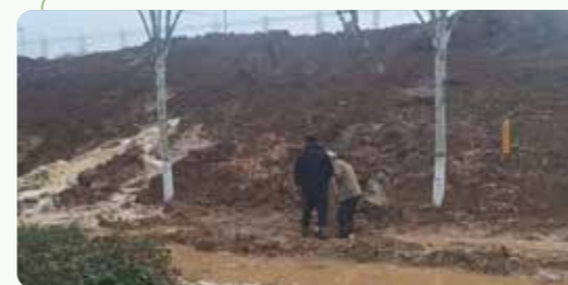
污水站工程师接到巡检人员电话公司东北角市政污水管网损坏漏水
