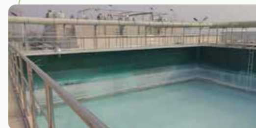
外排水很快被回流到事故池（容量 5000m 3 ，为一天的量）
